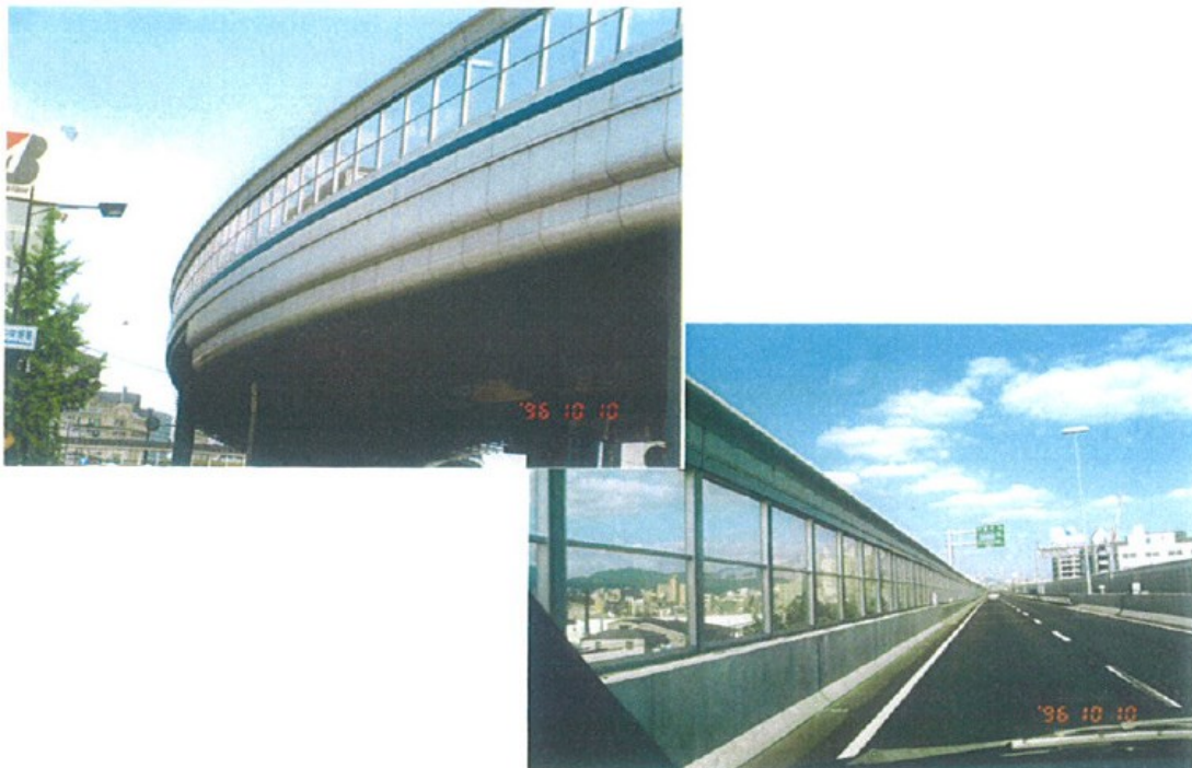
写真4 株式会社海田金属が製造した関西空港のアクセス道路の防音壁
